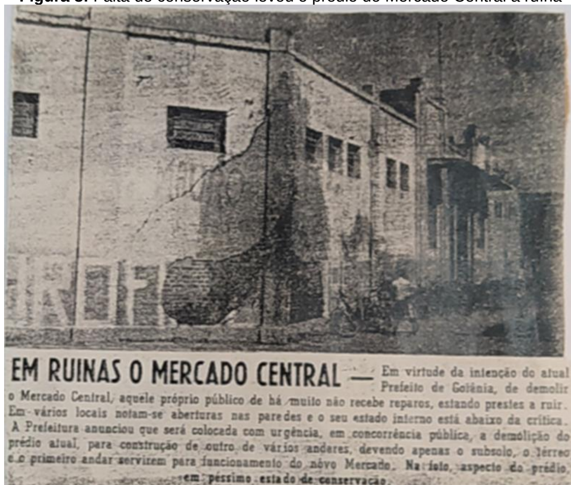
Figura 8: Falta de conservação levou o prédio do Mercado Central à ruína
