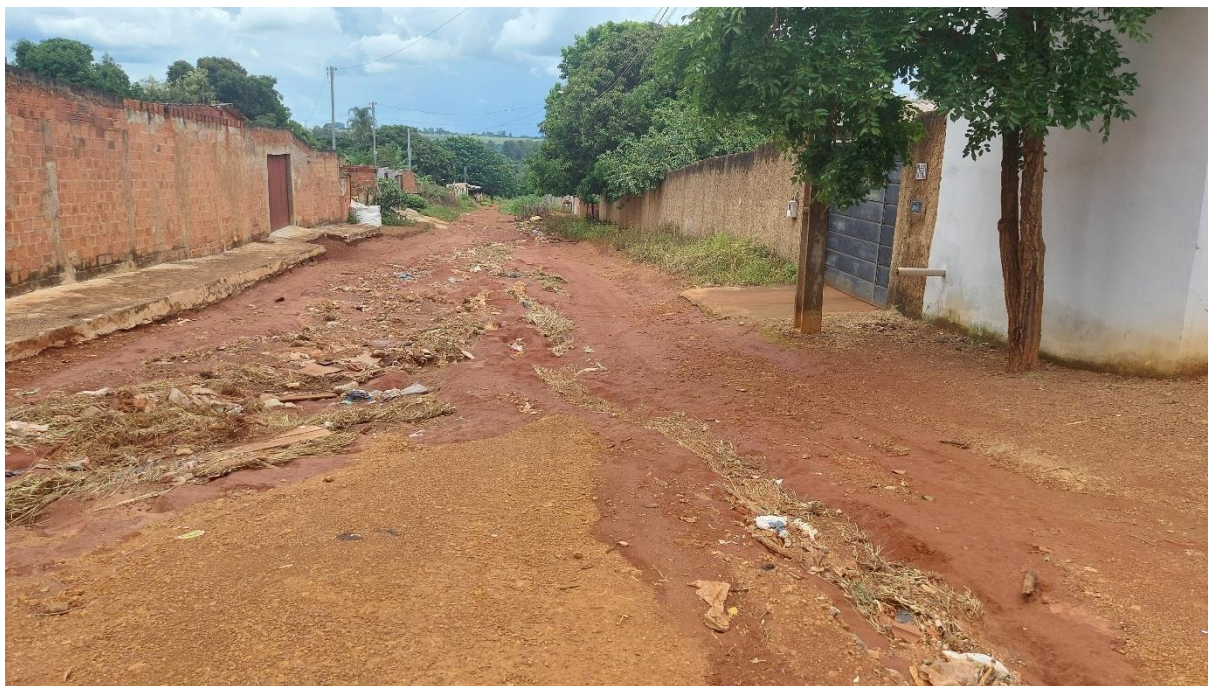
Figura 16 – Rua Pérola - sem esgotamento ou redes de escoamento de águas pluviais
