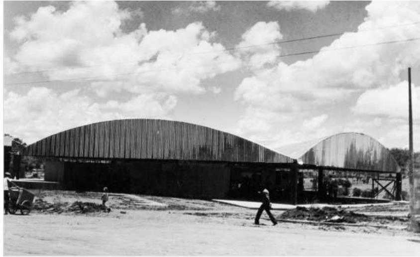
Figura 51 - Terminal Rodoviário sendo construído em 1970 (23ª imagem do vídeo) Fonte: Acervo particular de Eryl Barbosa
