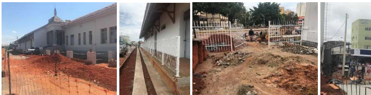
Figuras 184 e 185: Construção das calçadas. Figura 186: Construção da garagem administrativa. Figura 187: Instalação de padrão de energia para Estação. Fonte: Imagens capturadas pela autora.
