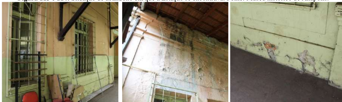
Figura 115: Grades metálicas instaladas sobre os vãos de janela. Figura 116: Infiltração na cobertura. Figura 117: Embasamentos de parede atacado por umidade ascendente. Fonte: Farsette, 2013.
