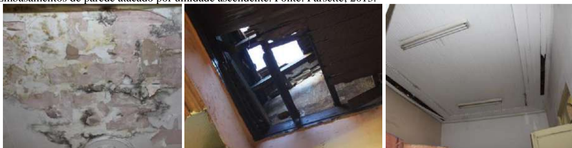
Figura 118: Forro de estuque deteriorado por umidade fruto de infiltração. Figura 119: Forro do hall de embarque deteriorado por infiltração. Figura 120: Forro em madeira deteriorado por infiltração. Fonte: Farsette, 2013.
