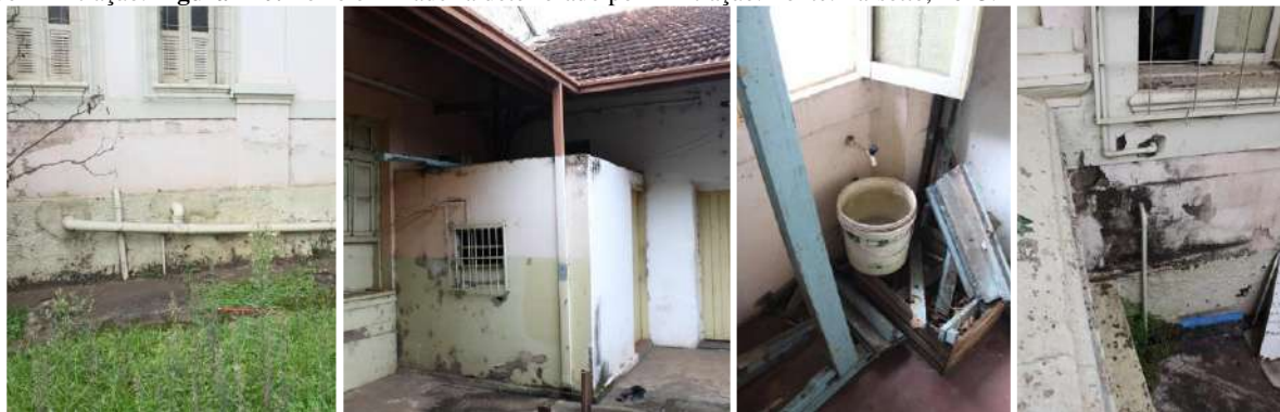
Figura 121: Instalações hidráulicas nocivas e improvisadas. Figura 122: Acréscimo executado indevidamente. Figura 123: Instalação de torneira de maneira inadequada. Figura 124: Danos aos revestimentos causados por infiltração. Fonte: Farsette, 2013.
