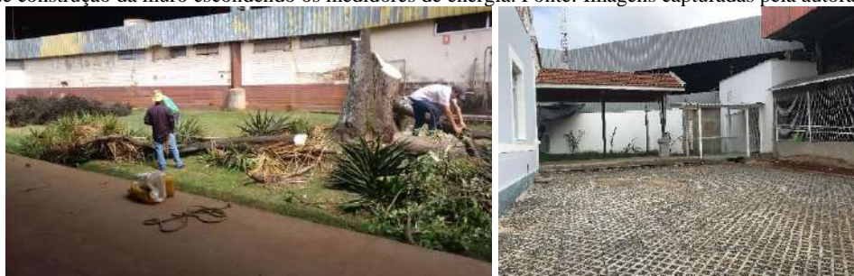
Figura 191: Retirada da vegetação existente para dar espaço ao painel histórico. Figura 192: Garagem administrativa e sanitários prontos. Fonte: Imagens capturadas pela autora.
