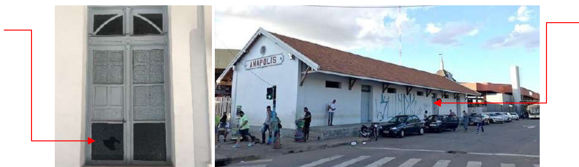
Figura 159: Janela da Estação danificada por vândalos. Fonte: Imagem capturada pela autora. Figura 160: Pichação no edifício da Estação. Fonte: Jornal “Contexto”.
