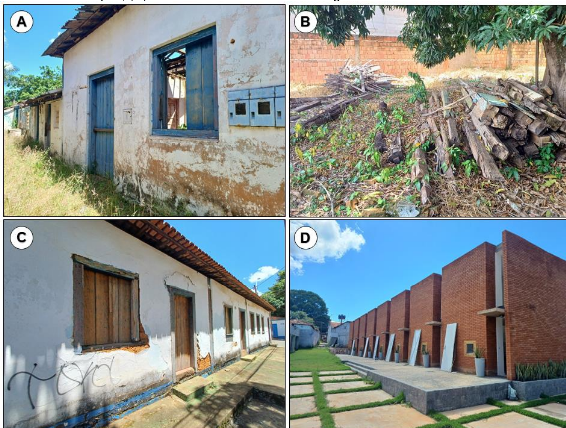
Figura 28 – Estado de conservação e preservação dos bens imóveis do Setor Tradicional de Planaltina em 2023: (A) Parte da fachada lateral norte do Antigo Armazém Goiás; (B) Restos do Antigo Casarão de Dona Negrinha; (C) Parte da fachada lateral oeste da Casa das Artes Dona Nilda Campos; (D) Atual imóvel construído no antigo lote do Casarão 5 irmãos.
