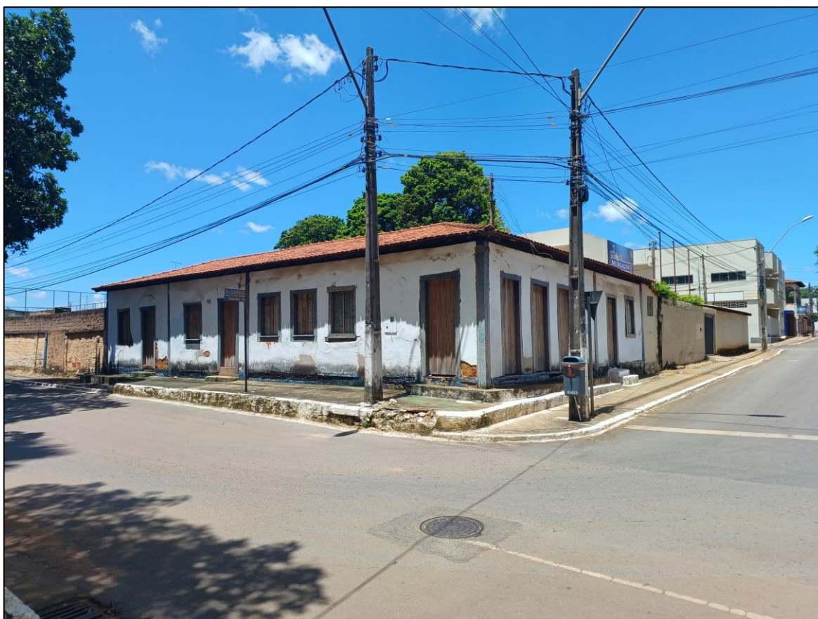
Figura 18 – Deterioração na fachada de um casarão situado no entorno da Praça Cel. Salviano Monteiro Guimarães.
