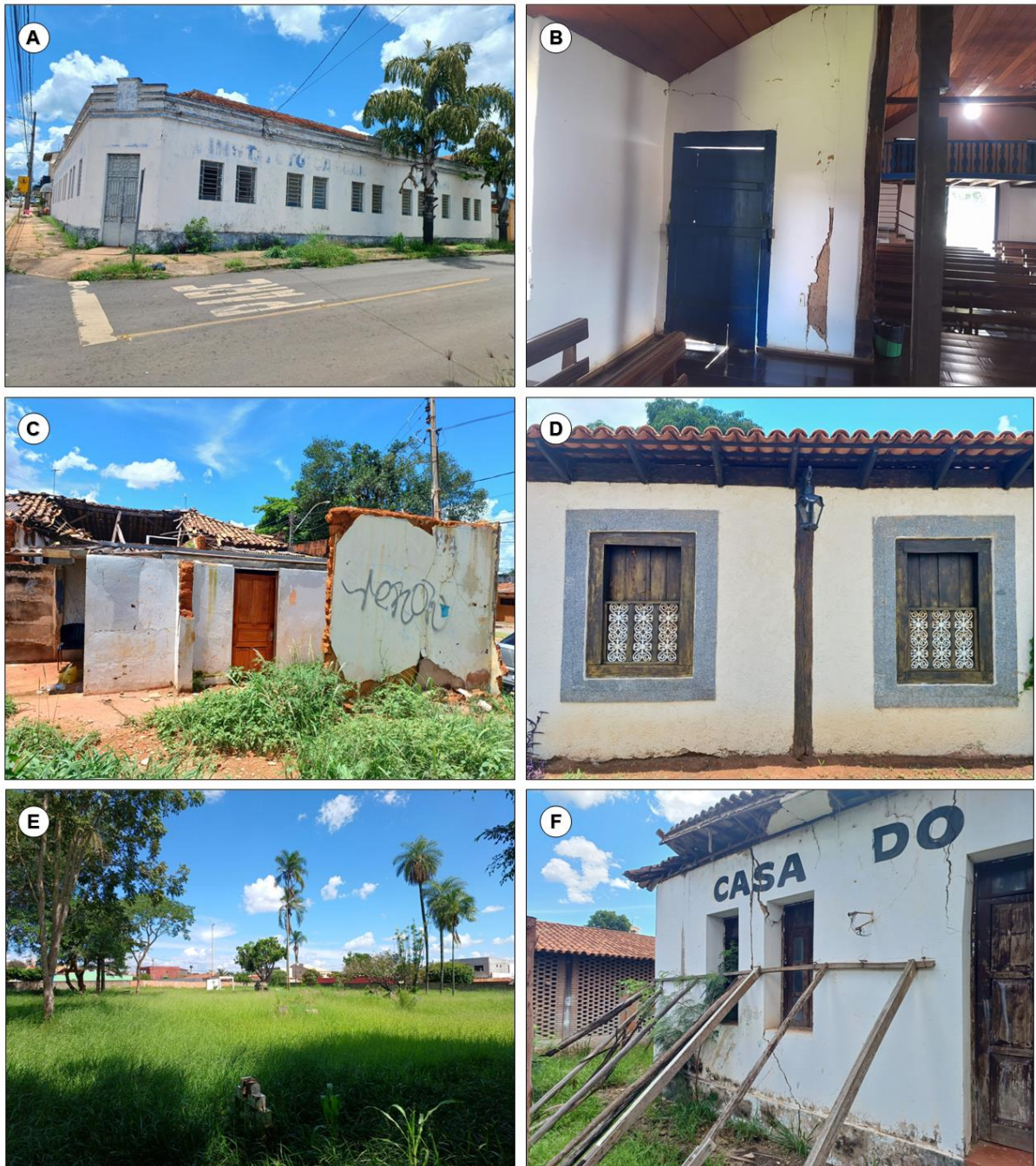
Figura 29 – Principais problemas de conservação e preservação dos bens imóveis do Setor Tradicional de Planaltina: (A) Falta de manutenção da fachada - Antiga Prefeitura; (B) Problema estrutural interno - Igreja São Sebastião; (C) Vandalismo e queda do telhado - Casa da Zona do Baixo Meretrício; (D) Descaracterização - Antiga Coletoria; (E) Abandono - Cemitério São Sebastião; (F) Improvisos e amarrações inadequadas – Casa do Artesão.
