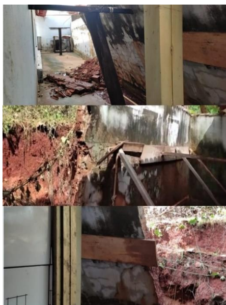
Fotografia 5 – Transtornos causados pela chuva em 2022 no Setor Vila Verde em Ceres-GO
