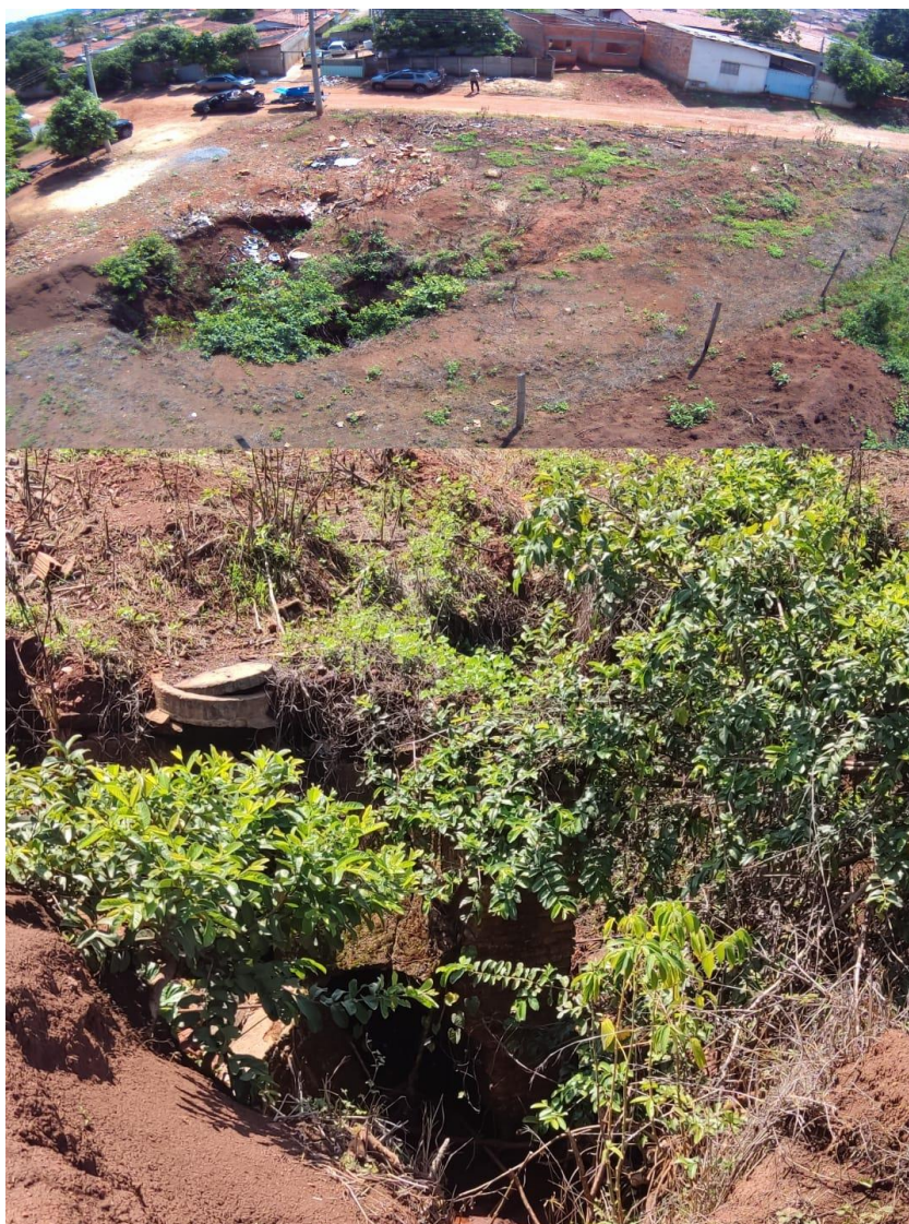
Fotografia 41 - Área desmoronada da canalização do Córrego Água Limpa
