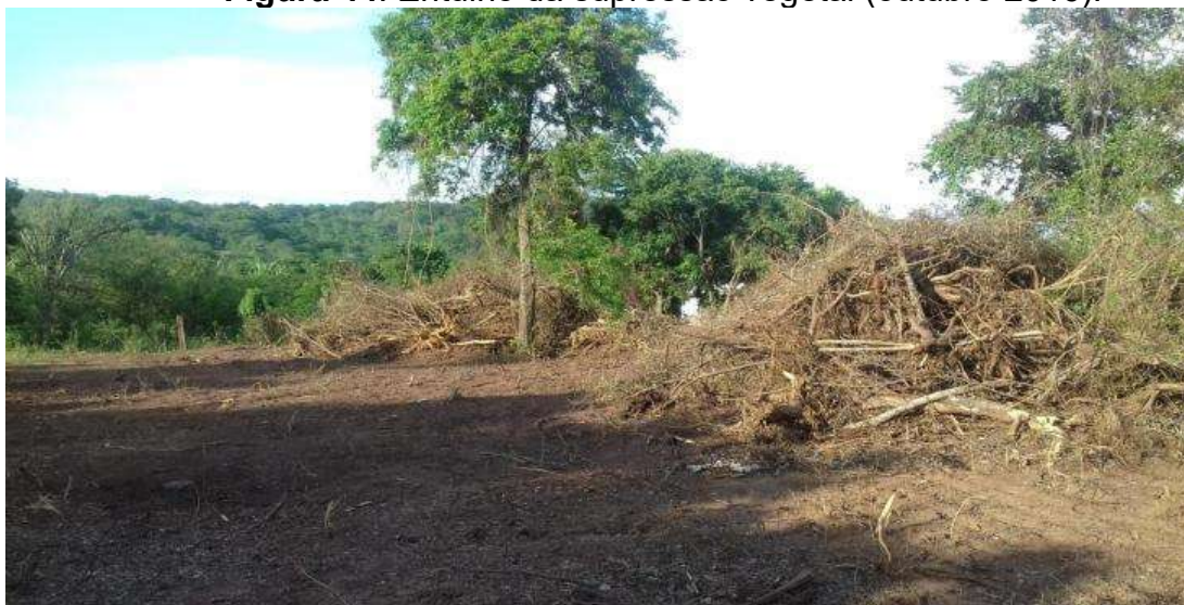
Figura 44. Entulho da supressão vegetal (outubro 2016).
