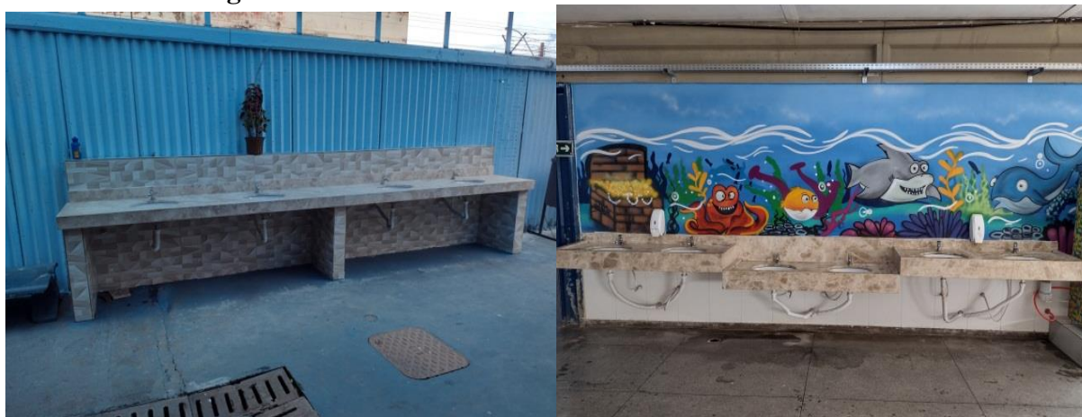
Figura 07 – Lavabos do Centro de Ensino Fundamental 403
