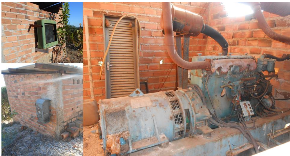
Figura 33. Equipamento antigo de mineração (tritador / moinho) em casebre na cava em trecho em desuso.
