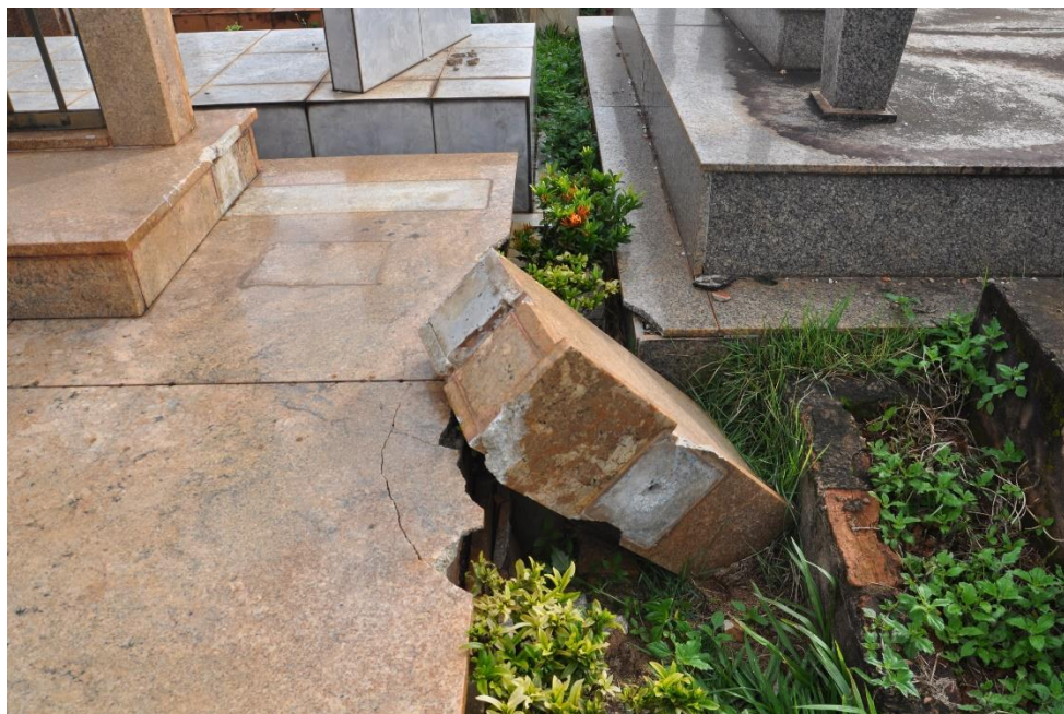
Figura 14 – Túmulo depredado. Cemitério Santana, Goiânia-GO.
