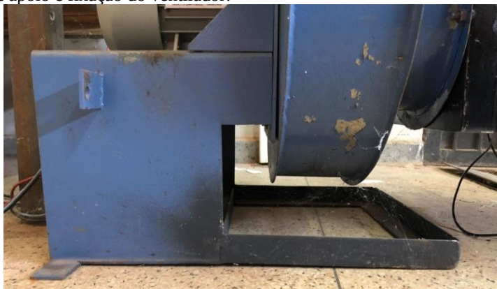
Figura 15 - Suporte de apoio e fixação do ventilador.
