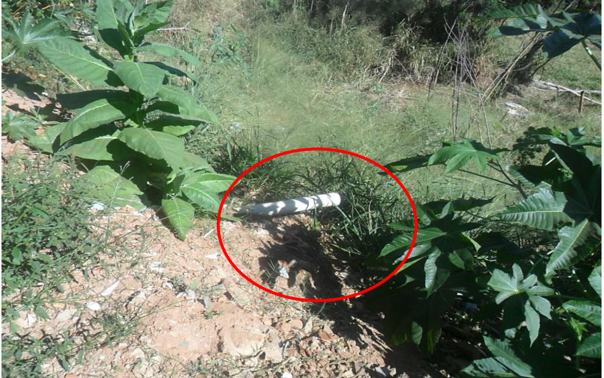
Ilustração 19 – Cano de esgotamento sanitário a céu aberto.
