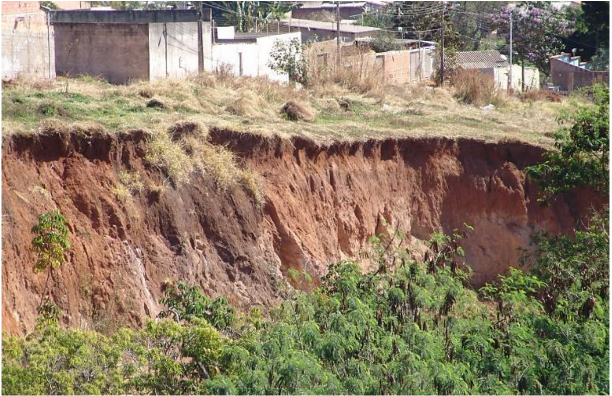
Ilustração 13 – Erosão acelerada na Avenida Ferroviária, Vila Formosa.
