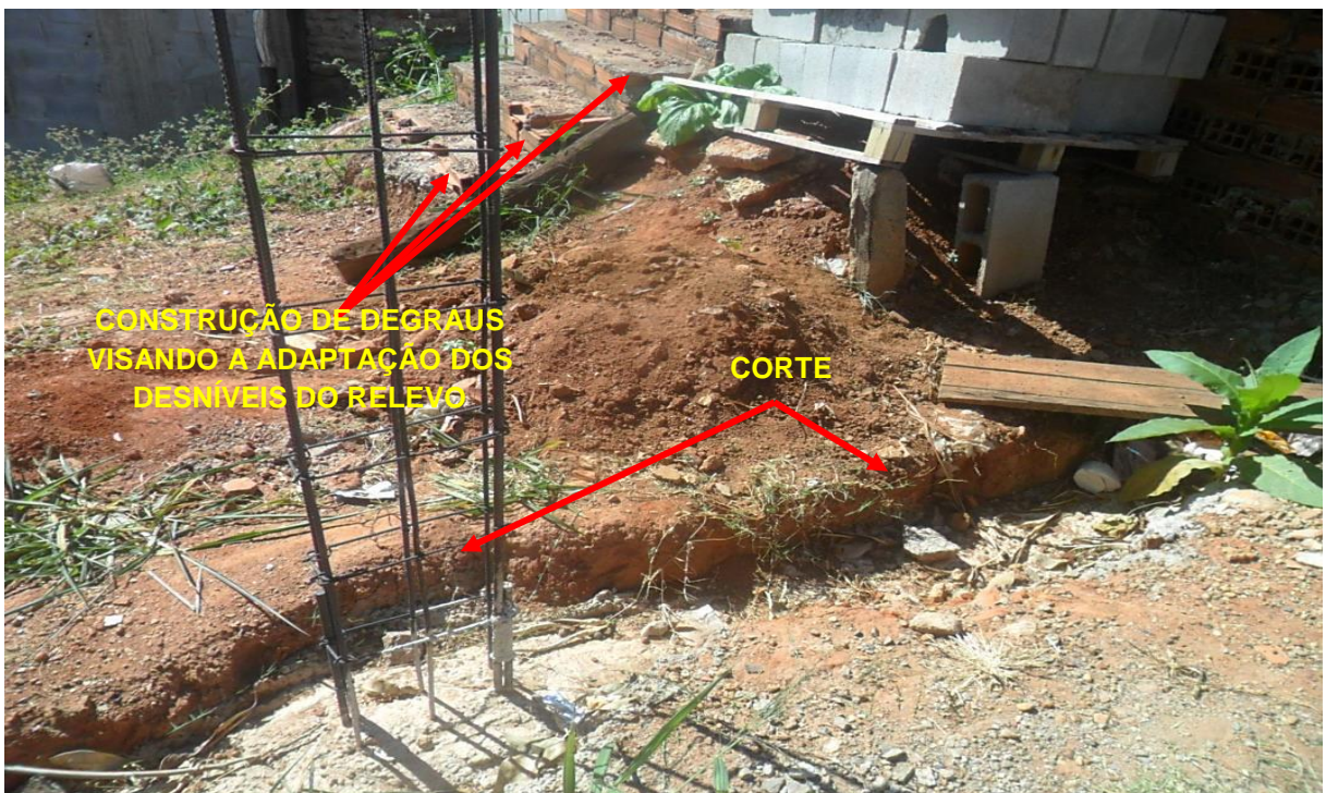
Ilustração 20 – Corte no relevo visando a adaptação de área vulnerável no Bairro Itamaraty.
